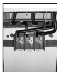
Utility lug landing
