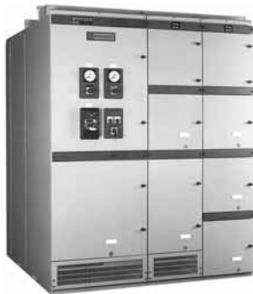
DSII Switchgear Assembly
